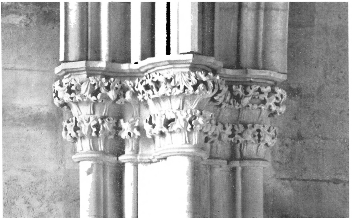
Gotisches Blätterkapital aus Aflenzer Kalksandstein bei einem Pfeiler im Mittelschiff des St. Stephansdomes in Wien.
